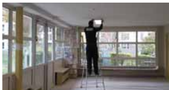
Poursuite du remplacement de tous les luminaires par du LED dans les écoles : M.Cachin, Joliot-Curie, J. Jaurès et N. Mandela.
